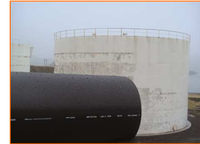
9の 貯蔵タンク
